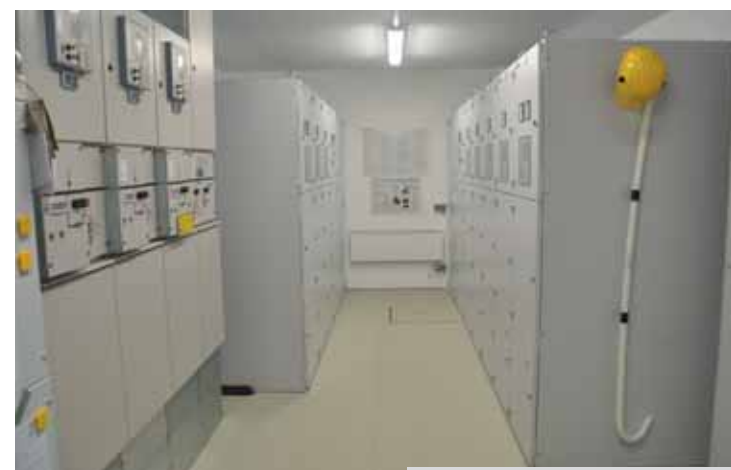
Mittelspannungsschaltanlage und Gleichrichter
