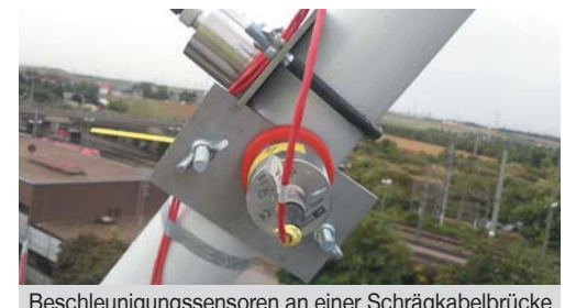
Beschleunigungssensoren an einer Schrägkabelbrücke
